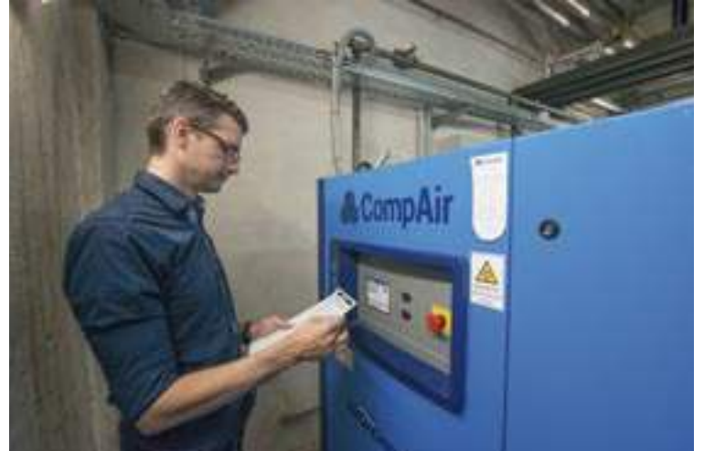
René Blumauer vor dem neuen Kompressor
