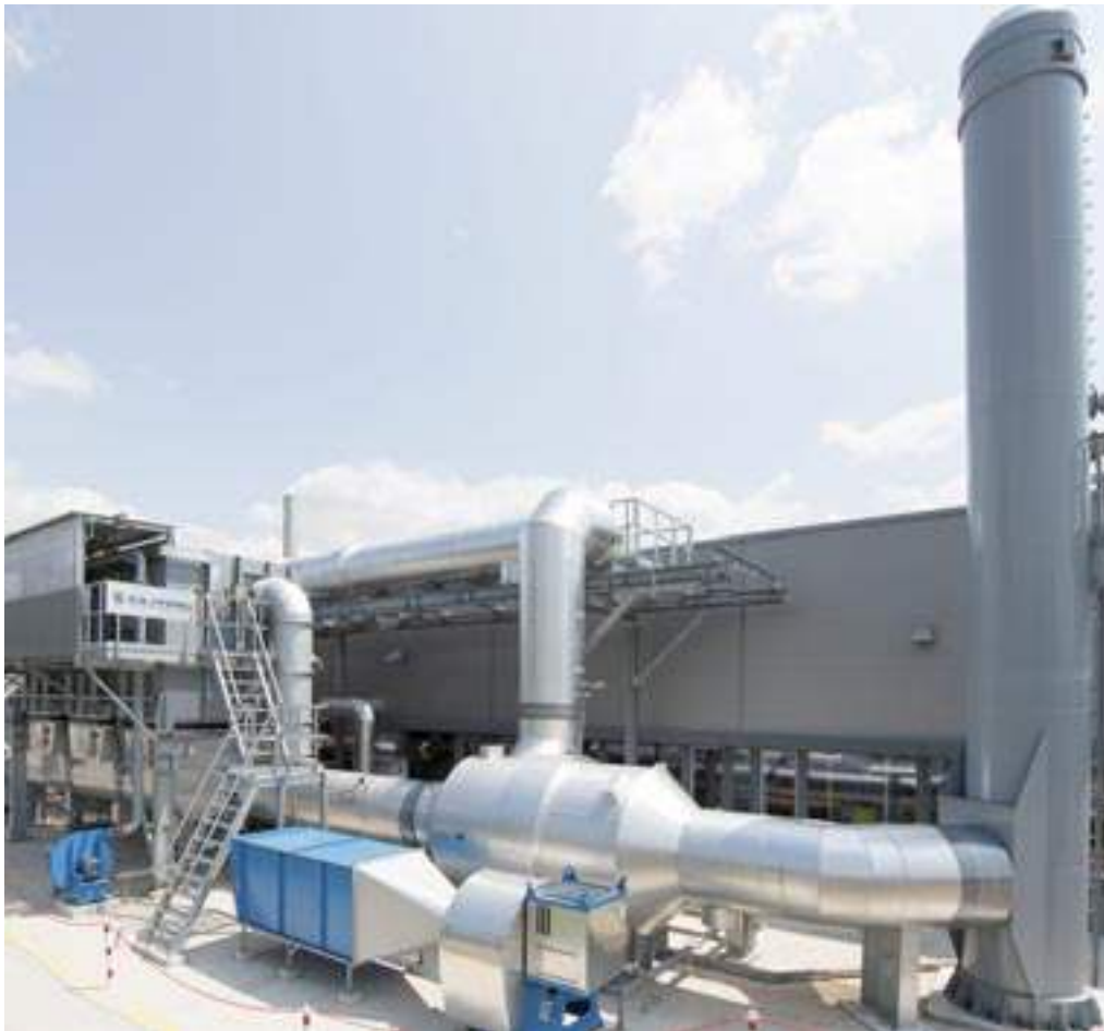
So sieht Luftreinhaltung aus – die neue RTO zur Abluftreinigung.
